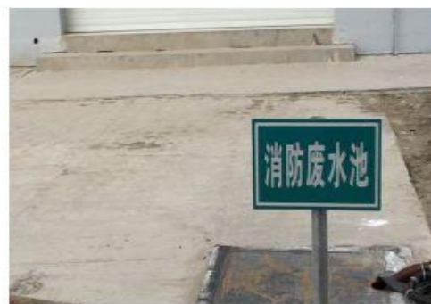
冷却塔排污水回用池(集中到消防废水池处理)
