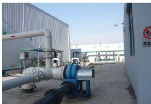
渗滤液预处理站
